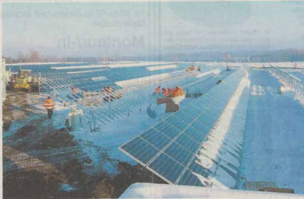
Bei Schnee und Kälte werden die mehr als 12 000 Module für den Solarpark in Falkenhain installiert. Foto: Johannes Bartke
