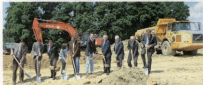
Beim Spatenstich für den Windpark im Blumenthaler Forst: (von links) Wolf-Stefrich Graf von Habs (Fuggenschütz Stiftung), Robert Böhl (Sparkasse Dachau), Günter Hahn (VR Bank Adaltdorfer-Sielenbach), Anne Glas (Dasing), Ineg Merk (BGS Tiefbau), Sielenbachs Bürgermeister Martin Echter, Florian Bichler (Energiebauern), Aichachs Bürgermeister Klaus Habermann, Peter Barnhauser (Raiffeisenbank Kising-Mering) und Michael Brechtelsbauer (DZ-Bank Frankfurt).
