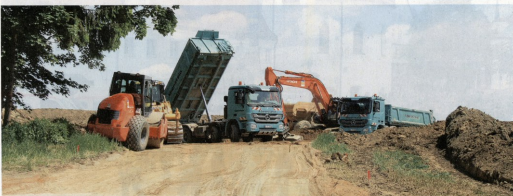
Nicht mit Spaten, sondern mit großen Gerät wird hier zwischen Sielenbach und Laimering eine Anlage des Windparks im Blumenthaler Forst der Bodon bereitet.
